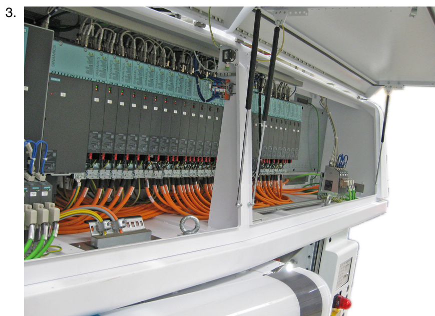
Beispiel: Schaltschranktüren an einer Mehrspindel- Drehmaschine
